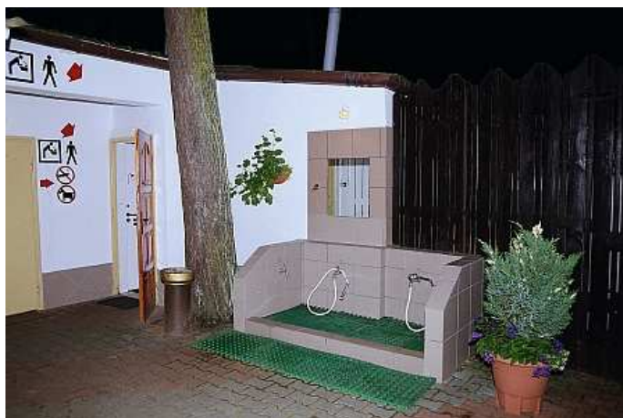
WC chemiczne na campingu [camping nr 194 „Wiking” w Dziwnówku]
