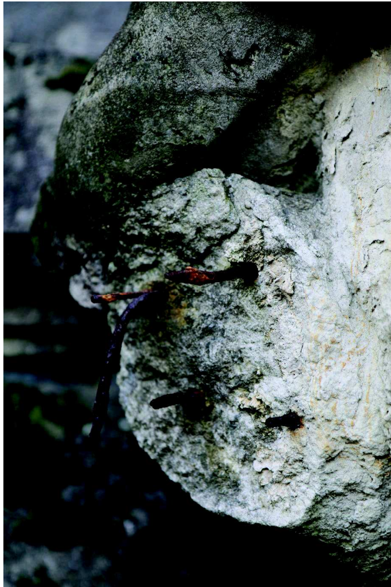
Fot.6. Pozostałości korodujących konstrukcji montowanych w kamieniu po zdegradowanych wtórnych uzupełnieniach.
