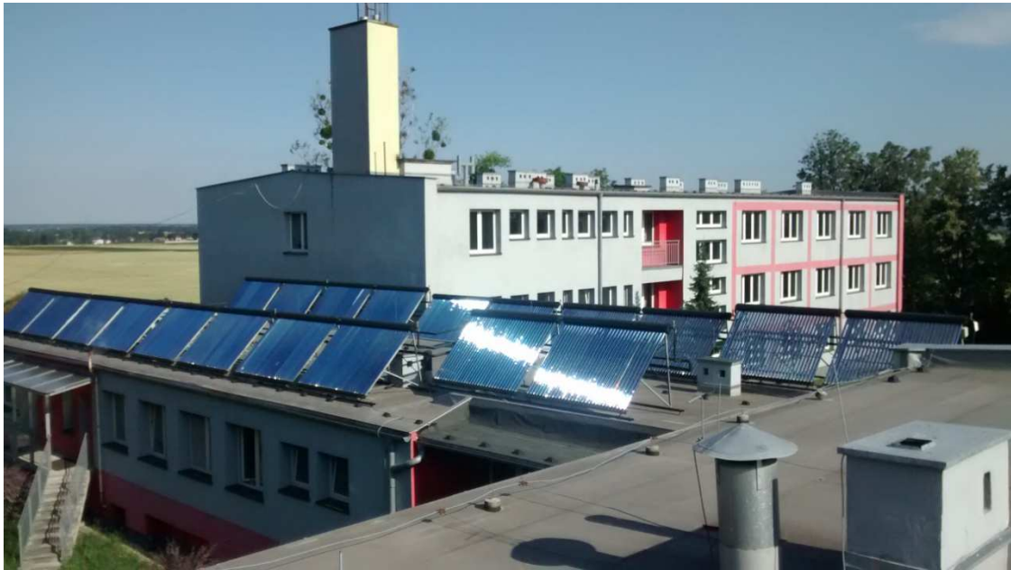
Rys. 5. Układ kolektorów słonecznych próżniowych na dachu internatu Zespołu Szkół im. Józefa Warszawicza w Prószkowie.
